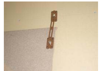
図1b 破損した天板
