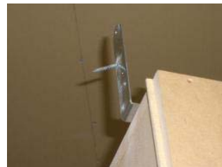
図1a 固定ビスの抜け出し
