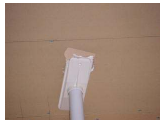
図1e 天井面破損
