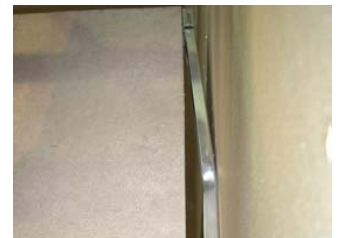
図1f レールの変形
