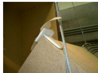
図1c 石膏ボード表面剥離
