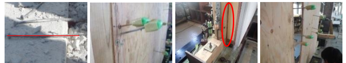
図 5 仕様③ 解体時の外装材用ビス 図 6 仕様④ 加力中の外装材用ビス 図 7 仕様③ 合板の開き無し 図 8 仕様④ 合板の開き
