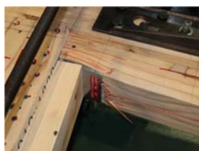
写真1 柱頭部のめり込み (全て)
