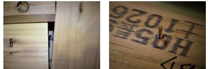
写真1 試験体損傷状況
